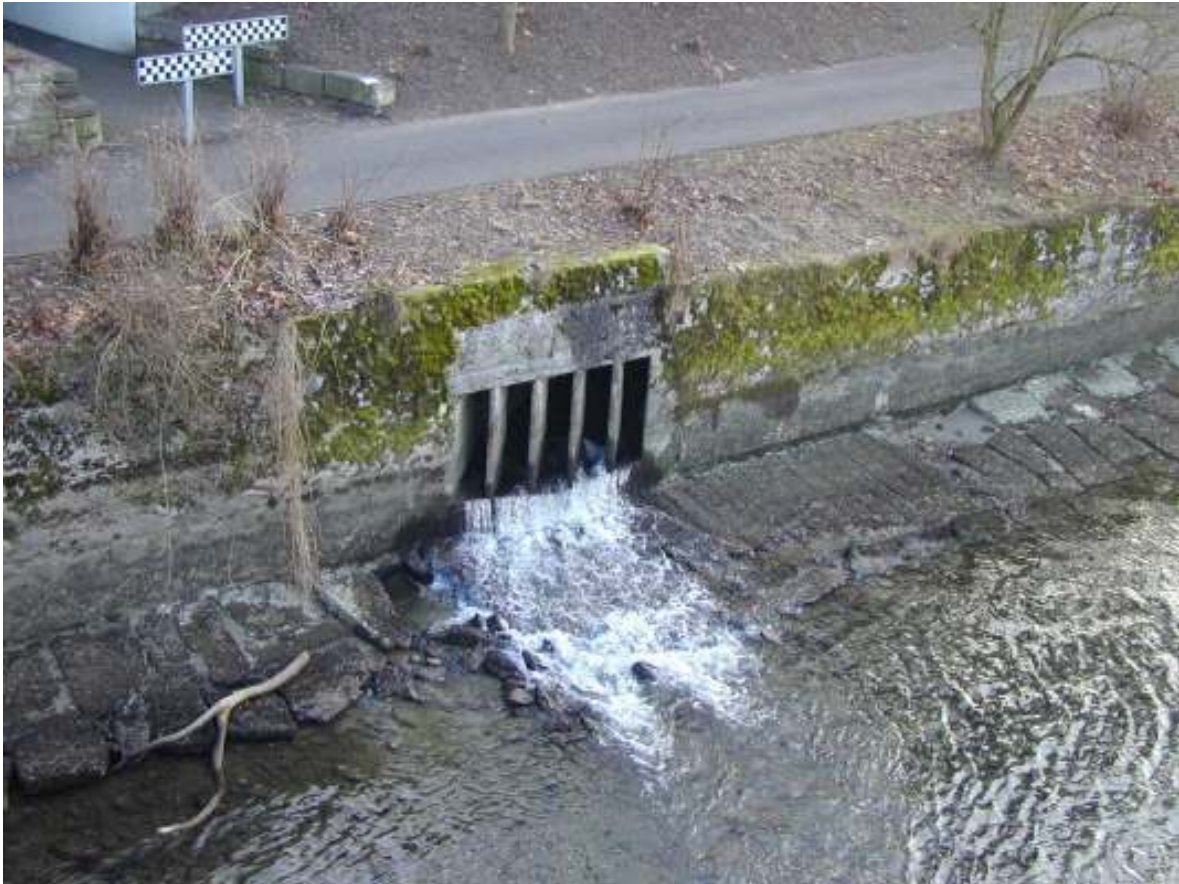
Abbildung 6. Die heutigen Naturwerte sind unter anderem wegen der verbauten Ufer gering. Die Lebensmöglichkeiten für Wassertiere, typische Ufervegetation, Silberweiden usw. sind unnötig stark eingeschränkt: Einlauf Stadtbach (Teil) oberhalb der Kettenbrücke.
