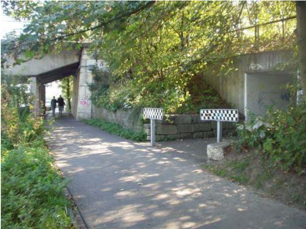
Abbildung 3. Trampelpfade und separat geführte Velowege fehlen: Fussgängerinnen und Fussgänger sowie Velofahrerinnen und Velofahrer müssen den gleichen befestigten Weg benutzen. Durchgang unter der Kettenbrücke.
